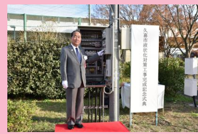
田中市長によりポンプを稼動
