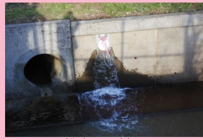
排水口の様子
