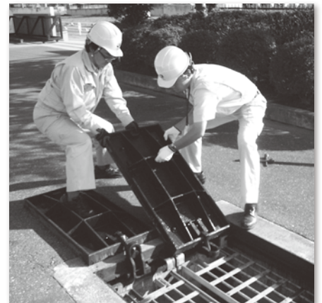
写真は栗橋西小学校にある緊急耐震性貯水槽です。地下に埋設されたこの貯水槽に給水設備をつなぎ給水します。
