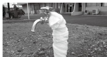
凍結防止のため水道管に布を巻いた状態
