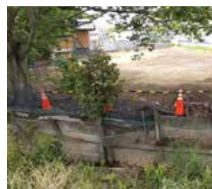
安全柵が必要な危険な水路
