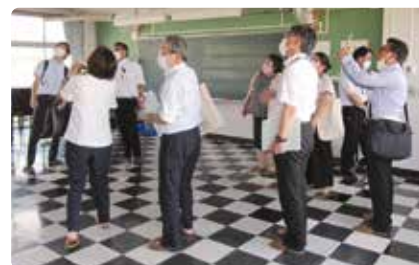
桜田小で雨漏り箇所を確認
