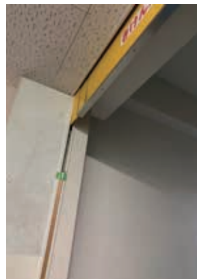
青葉小の防火シャッターのレールに突っかい棒
