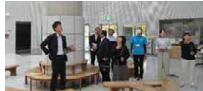
総合体育館にて雨漏り箇所を確認
