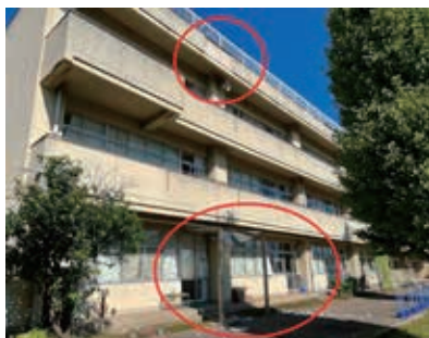
久喜東小学校の外壁落下直後
