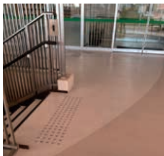
入口につながっていない 点字ブロック
