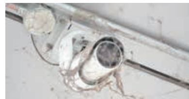
定期点検がされず、ゴミが滞留していた高所防犯カメラ
